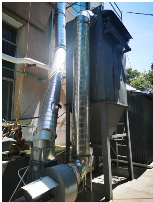
拉砂磨水口废气处理设施（布袋除尘器）
