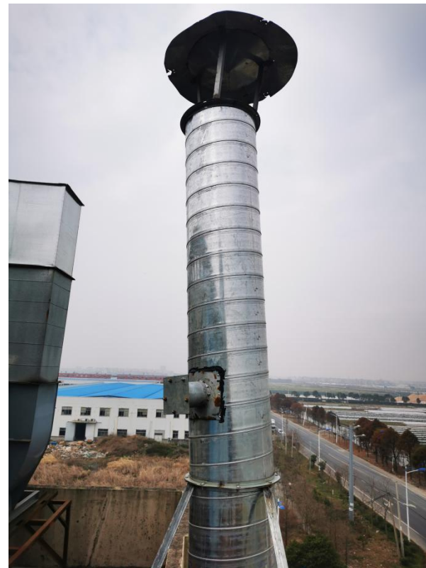
拉砂磨水口废气处理设施采样口
