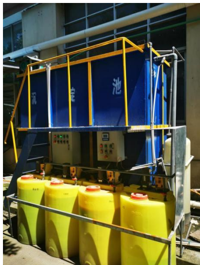
废水处理设施
