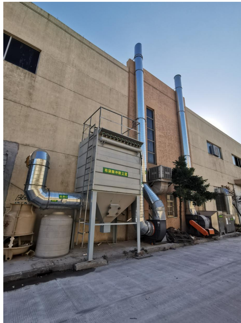
投配料粉尘废气处理设施（布袋除尘器）
