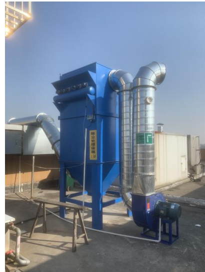
拉砂磨水口布袋除尘废气处理设施
