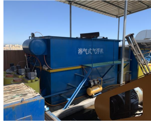
综合废水处理设施
