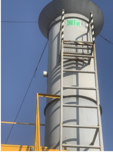
催化燃烧废气处理设施排放口
