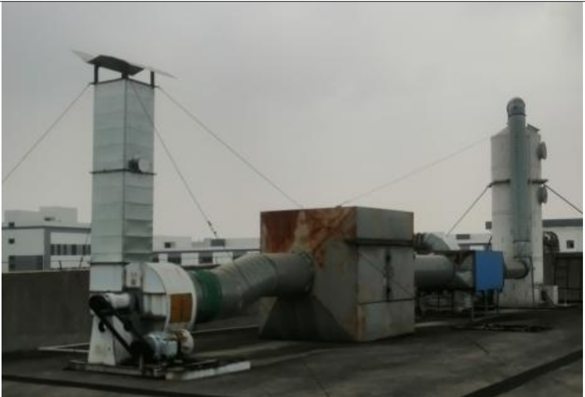
喷漆、流平烘干废气处理设施（喷淋塔+过滤棉、低温等离子净化+活性炭）
