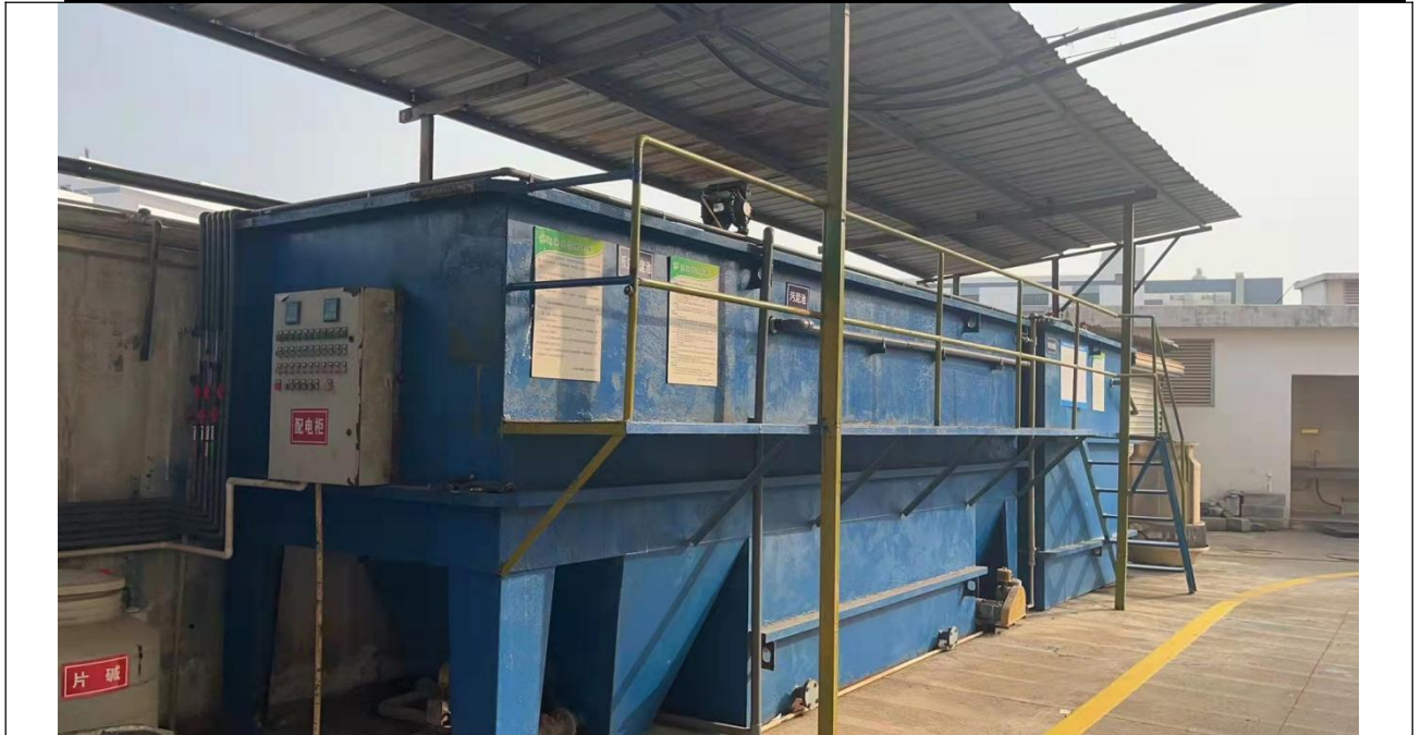
废水处理设施
