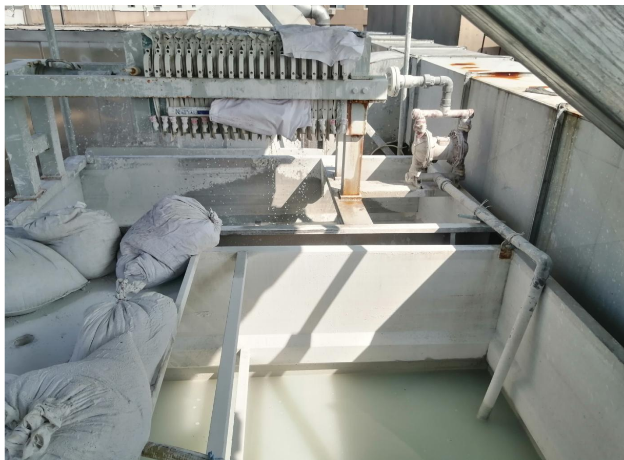
震机废水压滤装置
