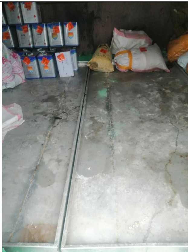
危废仓库门内部
