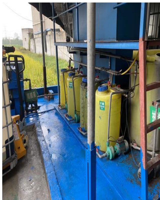
综合废水处理设施
