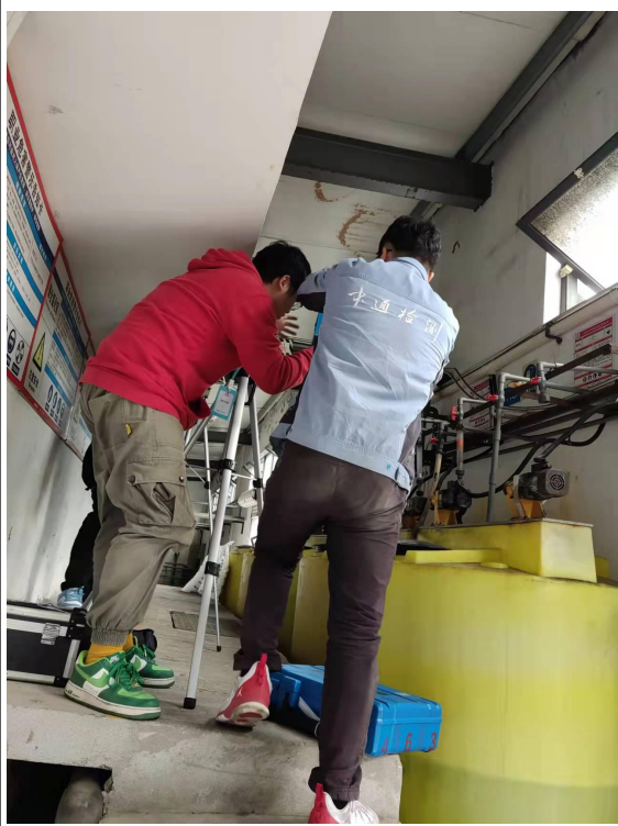
图 8 污水处理站岗位检测
