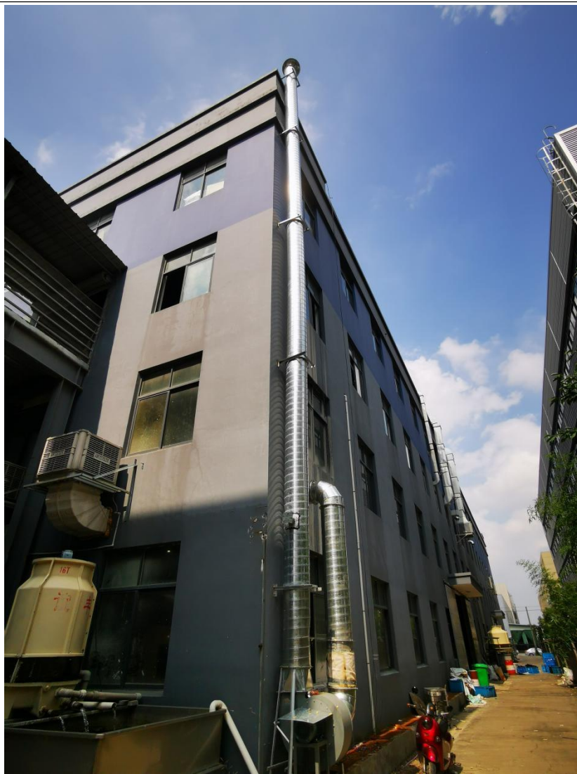
注塑废气处理设施（15m）
