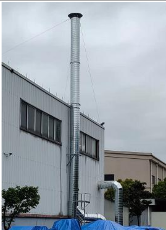
注塑切割废气排气筒
