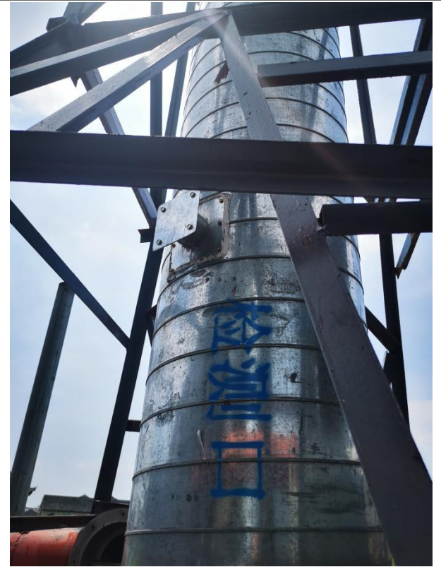
油漆废气处理设施检测口
